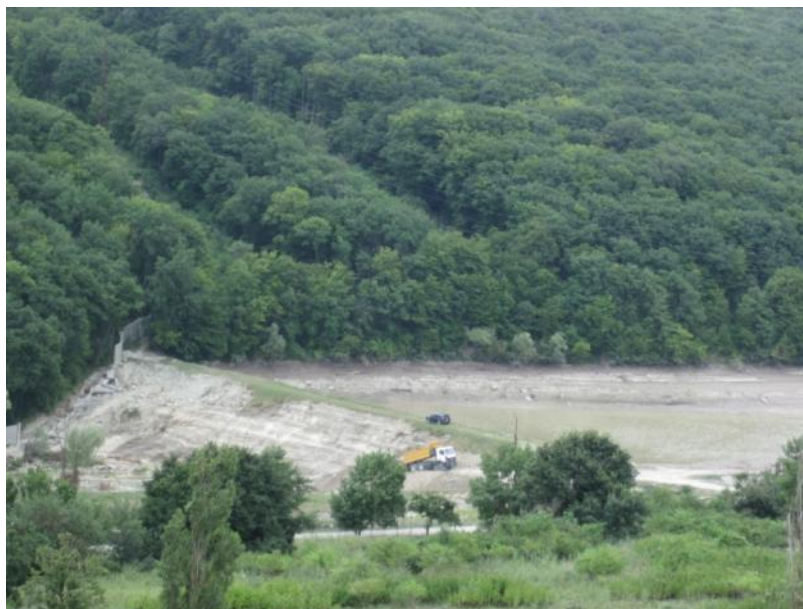
Рисунок 2.3. Повреждения дамбы пруда выше х. Жемчужный.
